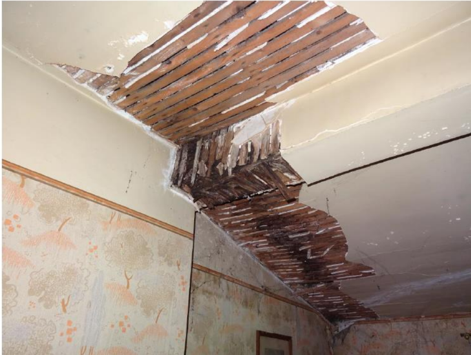
Niveau R+3 – latis plâtrés très abimés – pannes pourries sur appuis.
