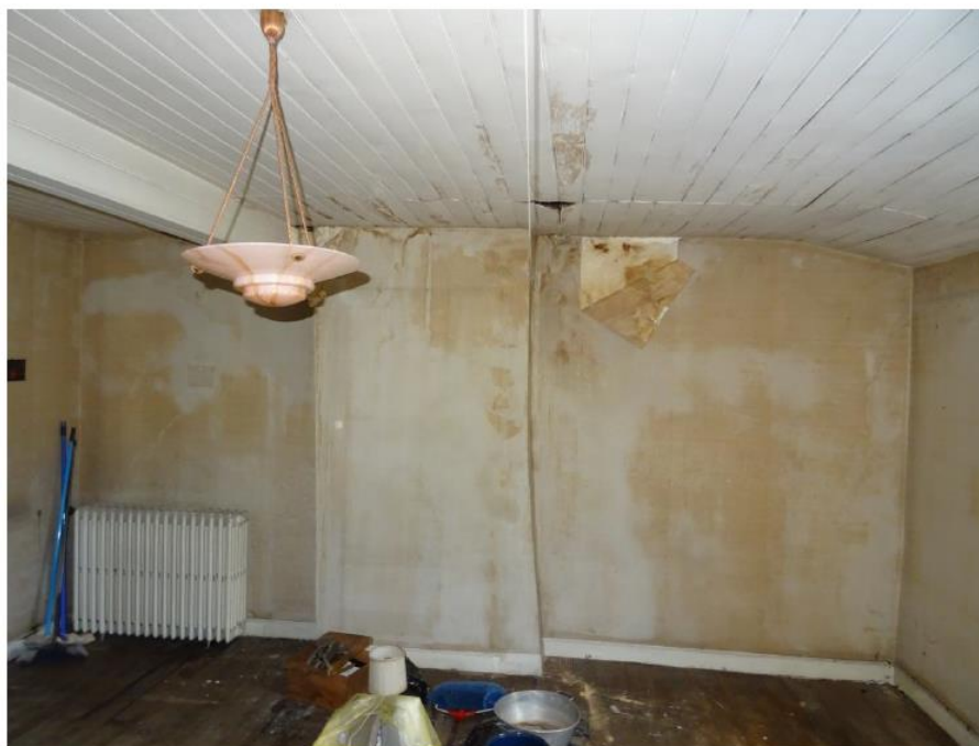
Vues sur le 3 ème étage, intérieur du logement vétuste, traces d'infiltrations d'eau en plafonds.
